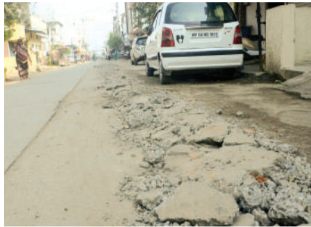
पाइप लाइन डालने के बाद फिलिंग नहीं की गई है।
